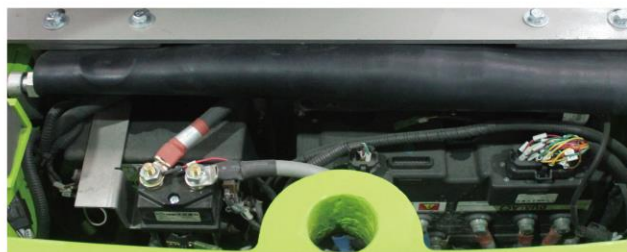
Porta posterior para aceder e controlar a manutenção elétrica.
